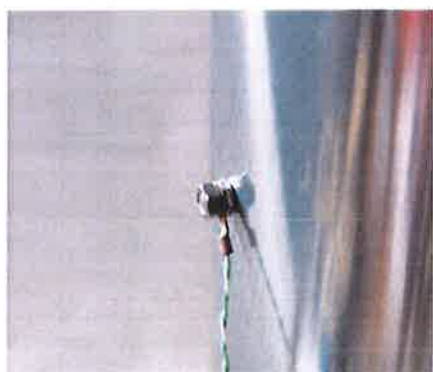
⇐ Installation d'une sonde Testo sur une cheminée
